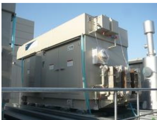
非常用発電機(浦安市 HP)
